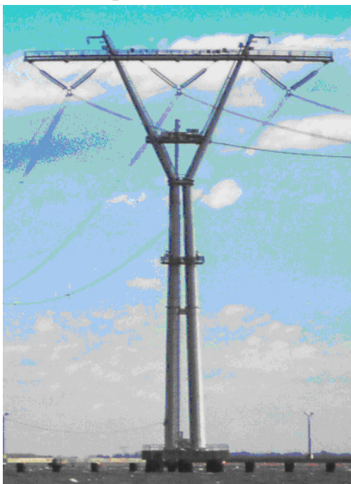
Рис. А.13 - Промежуточная опора большого перехода ВЛ 500 кВ
